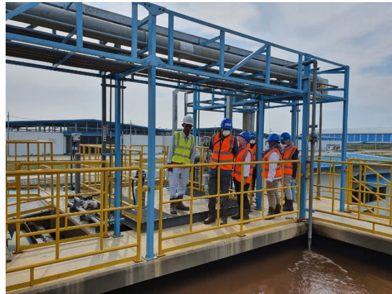
Gambar 4. Pengolahan limbah B3 cair dengan menggunakan metode biologis dengan menambahkan bakteri untuk mengolah limbahnya, salahsatu perusahaan yang berinovasi melakukan pengolahan limbah biologis. PT Dowa Eco System Indonesia
